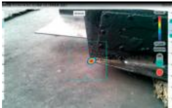
三角焊缝问题: 将导致漏油, 需返工
