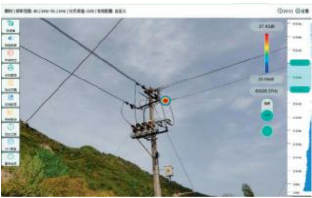
配网杆塔局放
