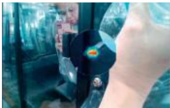
缝隙密封问题: 确认漏水
