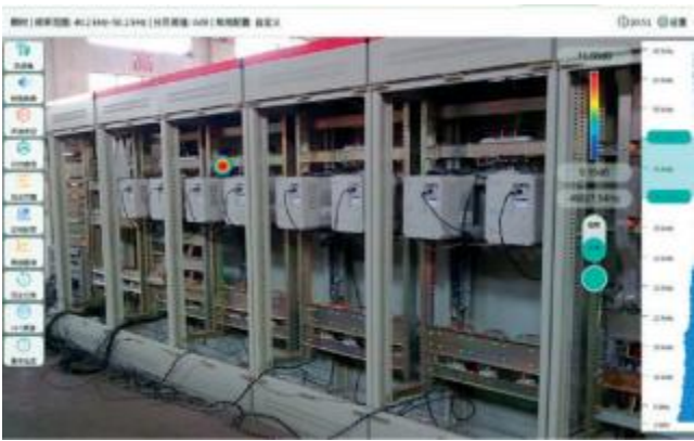
高压配电柜局放
