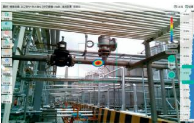
混合气体泄漏
