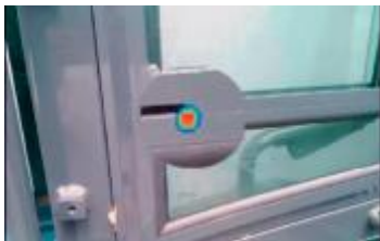
透气孔: 正在漏烟
