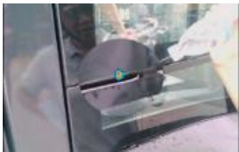
缝隙密封问题: 确认漏水
