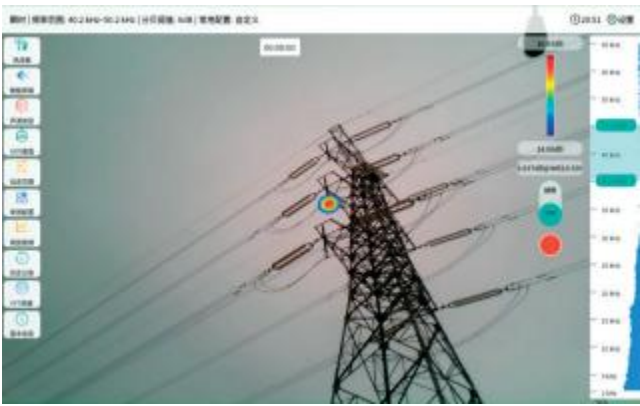
主网高压电塔局放
